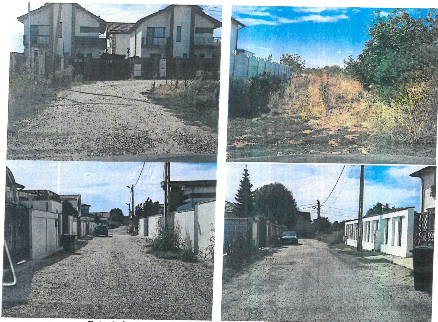
Foto 1. Aspecte parte carosabilă strada Uverturii, Domnești
